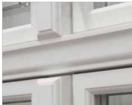
Gående lodpost under tværpost
